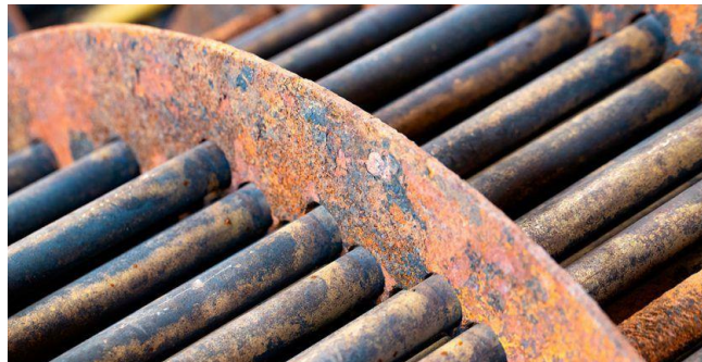
Figura 1.1 Corrosión en un intercambiador de calor de coraza y tubos Fuente: Arveng training & engineering [18]
