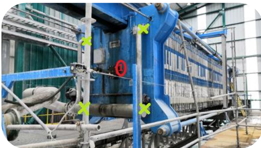
Figura 3.2 Canales de limpieza de alimentación (rojo) y secaje (verde) Fuente: Cesar Miranda. Visita a planta de procesamiento de mineral [31]
