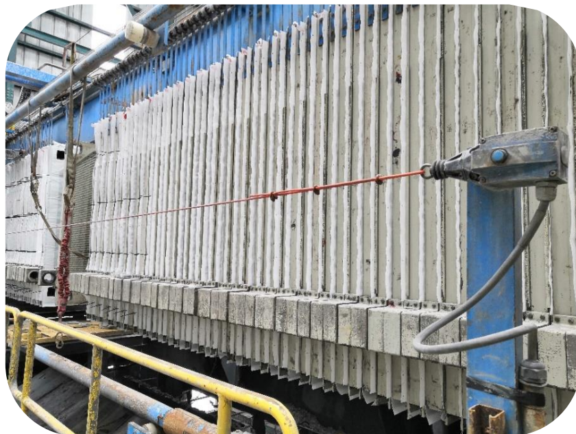
Figura 3.8 Línea de seguridad para la parada de emergencia del filtro Fuente: Cesar Miranda. Visita a planta de procesamiento de mineral [31]
