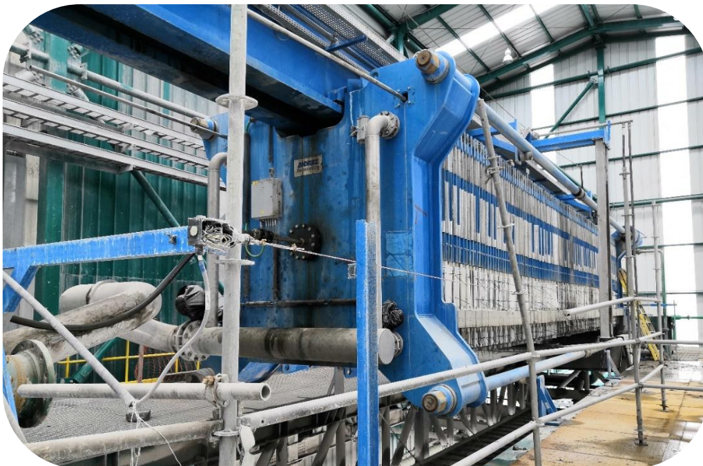
Figura 1.5 Filtro Prensa de Relave Modelo Andritz 2500 Fuente: Cesar Miranda. Visita a planta de procesamiento de mineral [31]
