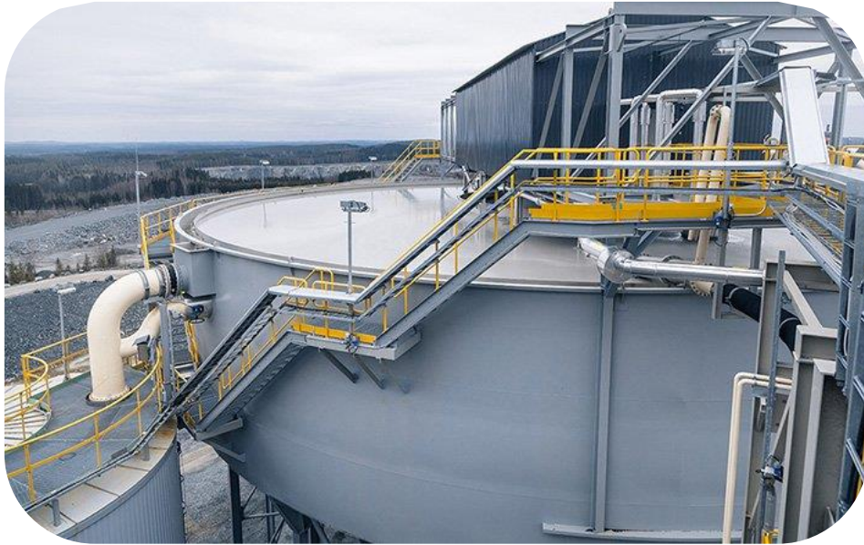
Figura 1.3 Sistema de espesamiento de relave
