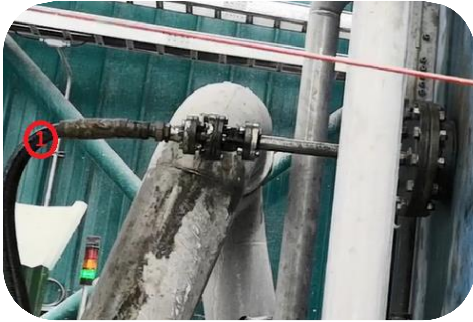
Figura 3.3 Vista lateral del canal de soplado del filtro prensa Fuente: Cesar Miranda. Visita a planta de procesamiento de mineral [31]
