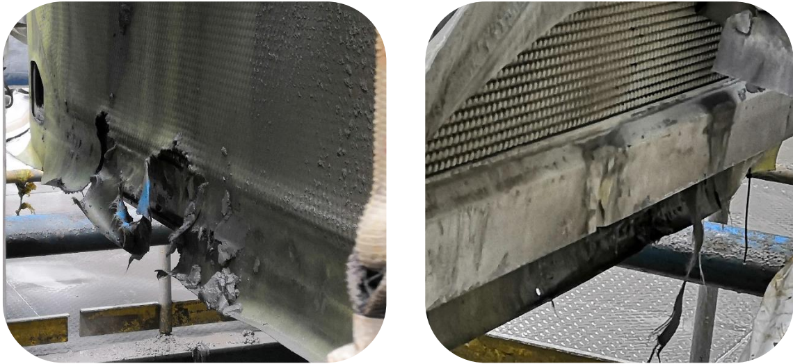
Figura 3.12 Evidencia de daño en lonas y placas de filtrado Fuente: Cesar Miranda. Visita a planta de procesamiento de mineral [31]
